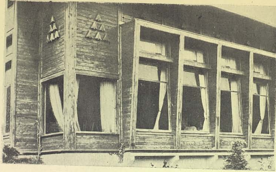
Res. 10 Abant'daki yeni otelin faya paralel cephesinde, camları zelzelenin tesiriyle tamamen kırılan pencereler
